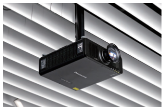
▲ 最初のエリアの天井に設置された1チップDLP®レーザープロジェクターPT-RZ690JLB
