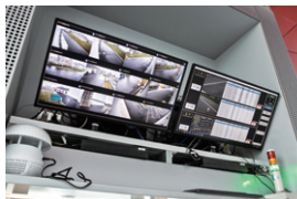
▲モニター左が駐車場内の監視カメラ映像。右は車両ナンバー識別画面
